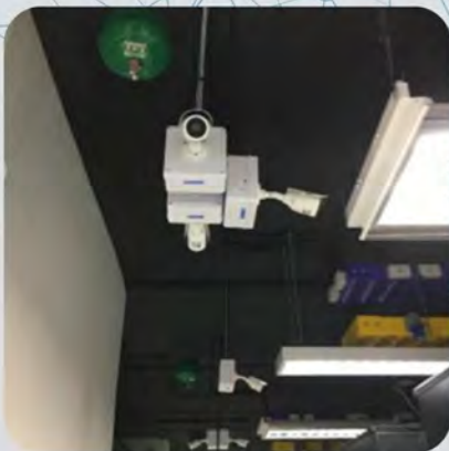
ระบบ CCTV
